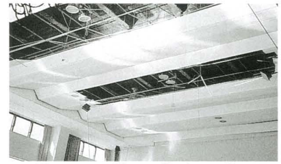
川口町公民館 天井ボード落下
